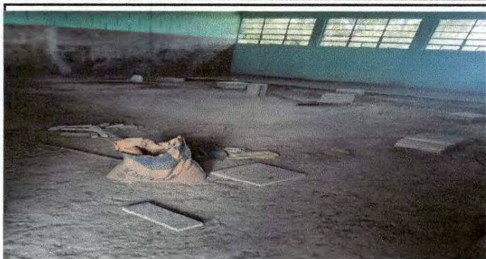
Foto 1: Sustrucción de piso de granito.
